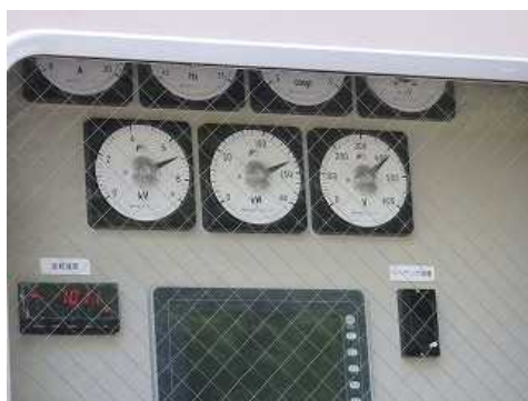
(既に稼働を開始している小水力発電設備)
