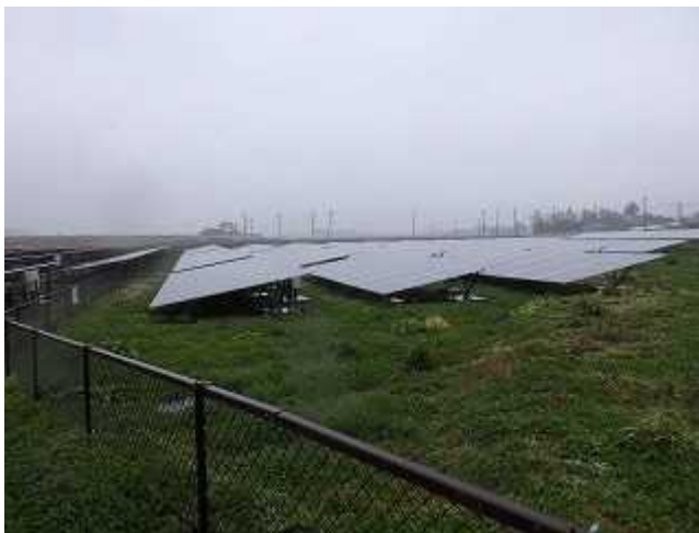
(太陽光発電所)
