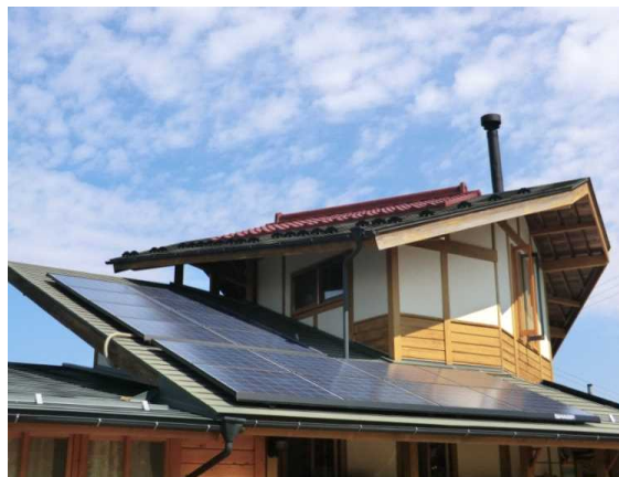
太陽光パネル
